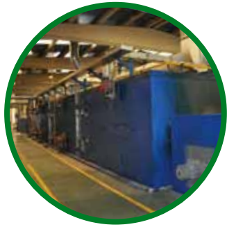
PU Coating Unit
